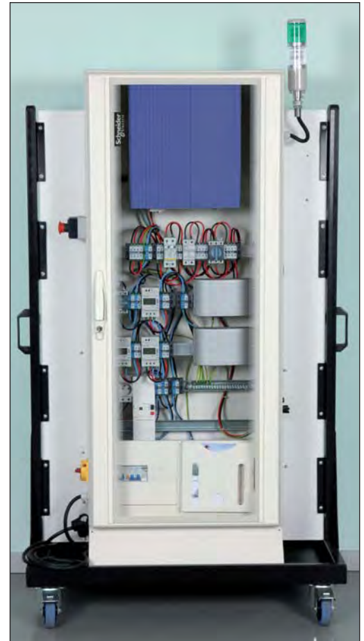
Côté armoire électrique centrale solaire
