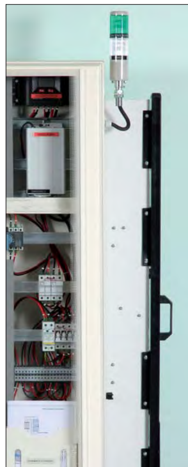
Côté armoire électrique centrale solaire
